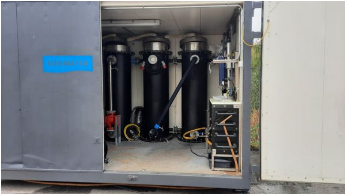
Vedenpuhdistuskontti. Kuva: Heli Vahtera
